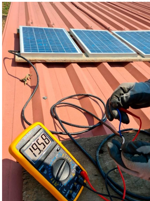
Figura 46. Prueba de funcionamiento y medición de voltaje en los paneles. Fuente: Autor
