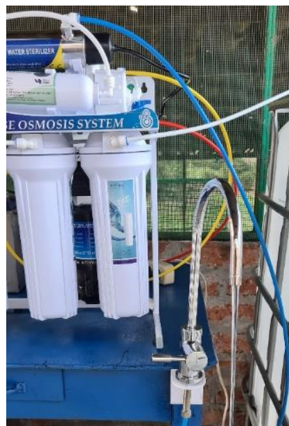
Figura 56. Funcionamiento de sistema potabilizador, suministro de agua. Fuente: Autor
