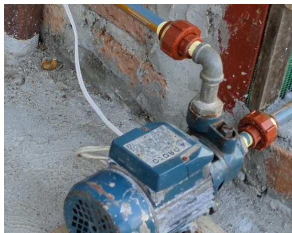
Figura 54. Bomba Pedrollo de \frac{1}{2} hp 110 V Fuente: Autor
