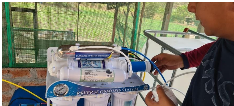
Figura 51. Instalaciones de Osmosis Inversa en el sistema potabilizador. Fuente: Autor
