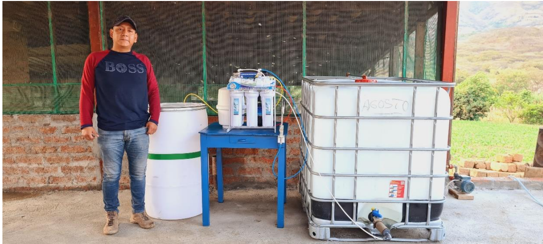
Figura 55. Tanques de almacenamiento completamente instalados Fuente: Autor
