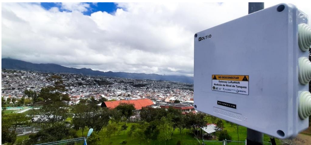
Figura 61. Caja con el Gateway Instalado
