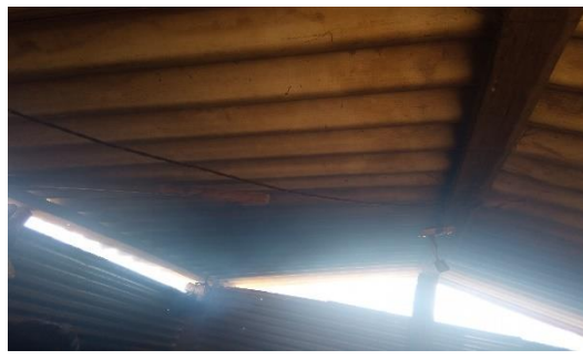
Figura 10: Hollín impregnado en el techo de una cocina a leña.
