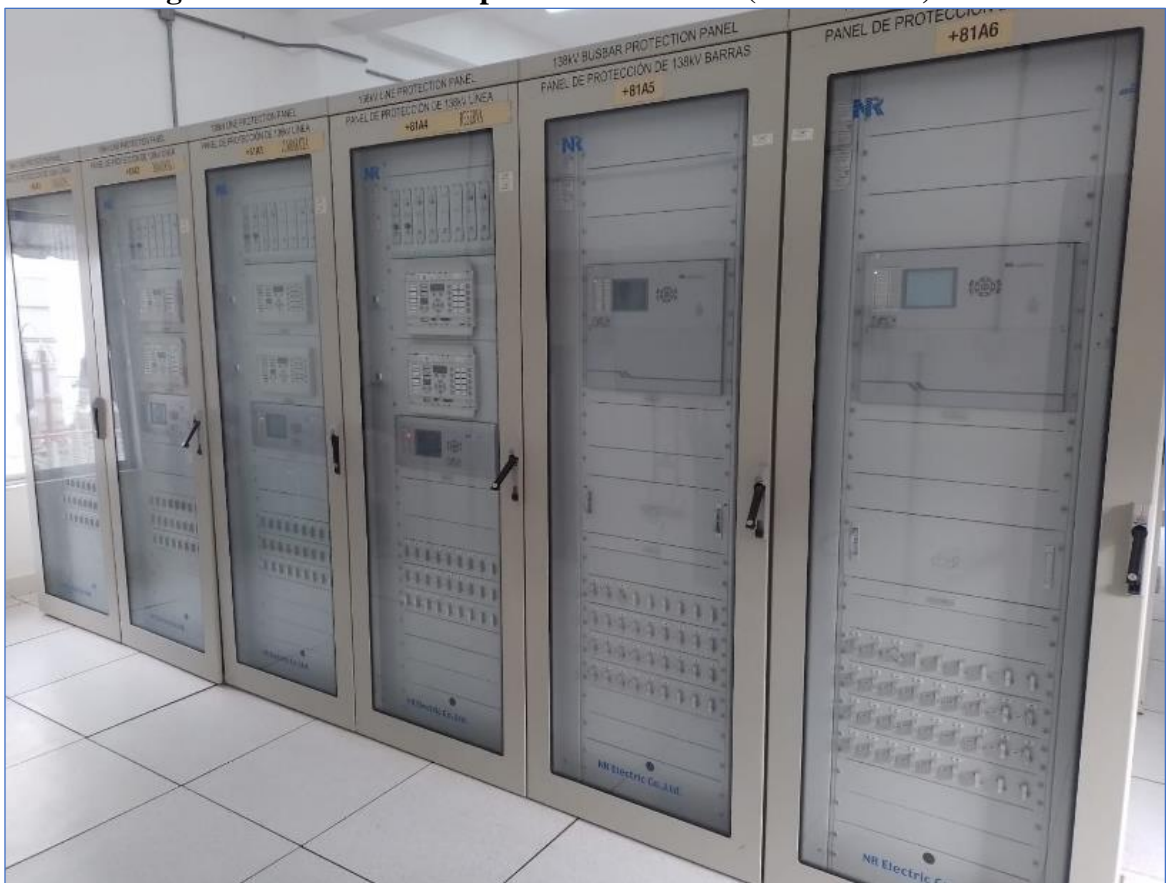
Figura 30 . Gabinetes de protección de línea (vista frontal)
