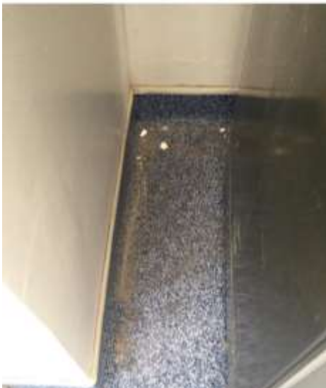
Rincón del piso cubierto de polvo
