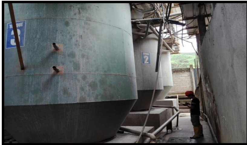
Fotografía 23. Tanques Reguladores de Densidad.
