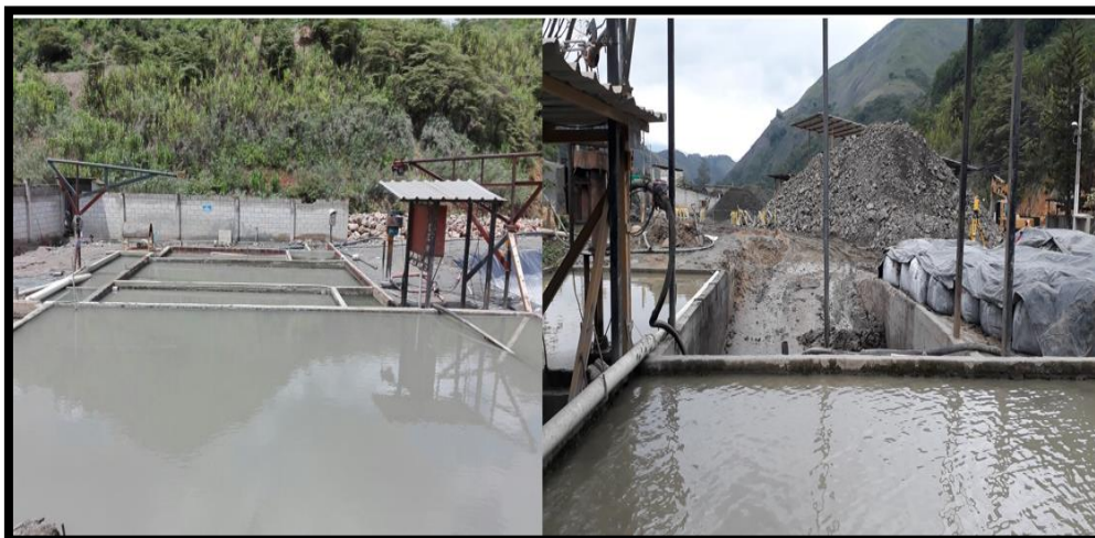
Fotografía 20. Piscinas de Sedimentación/Recirculación de agua
