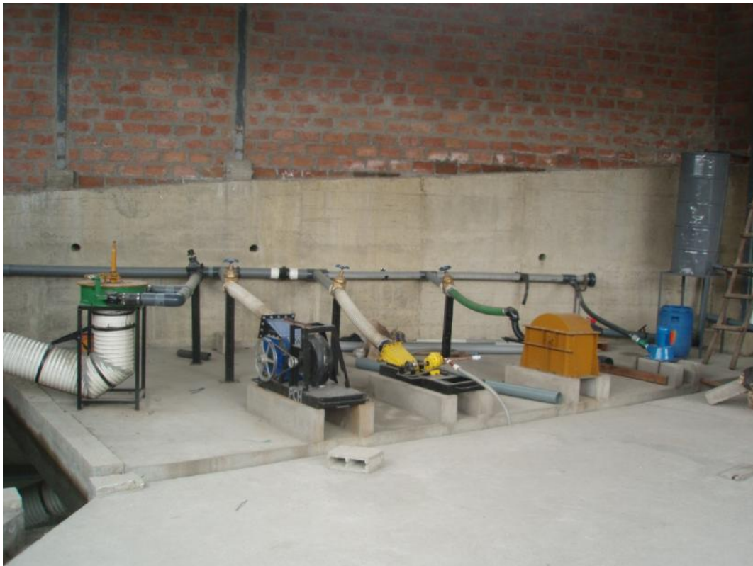
Fig. 13: Tubería de presión de 3 pulgadas. Fuente: Autor
