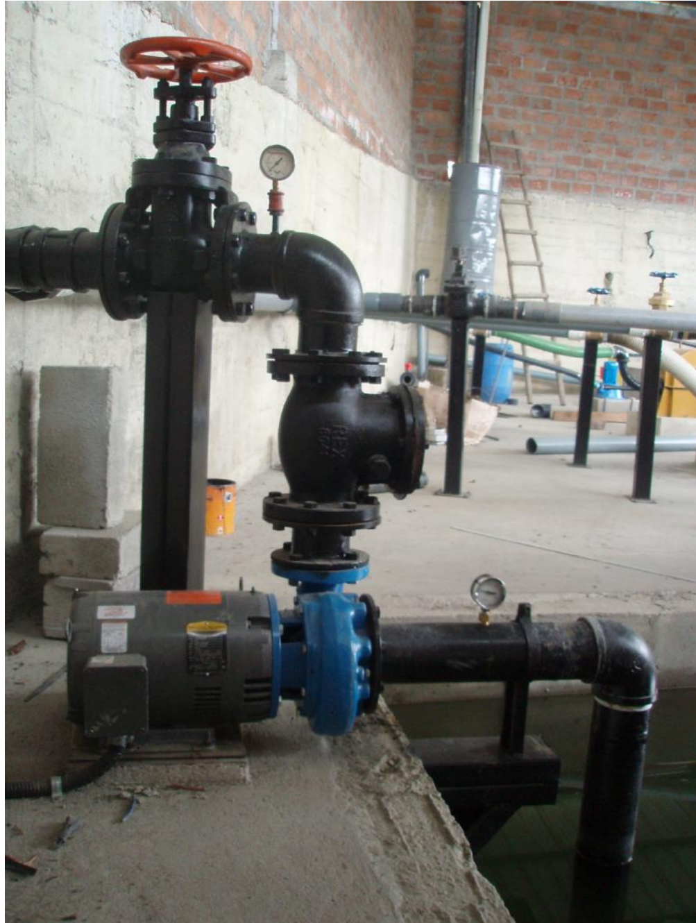
Fig. 19: Imagen de la bomba trifásica de 10 HP.
