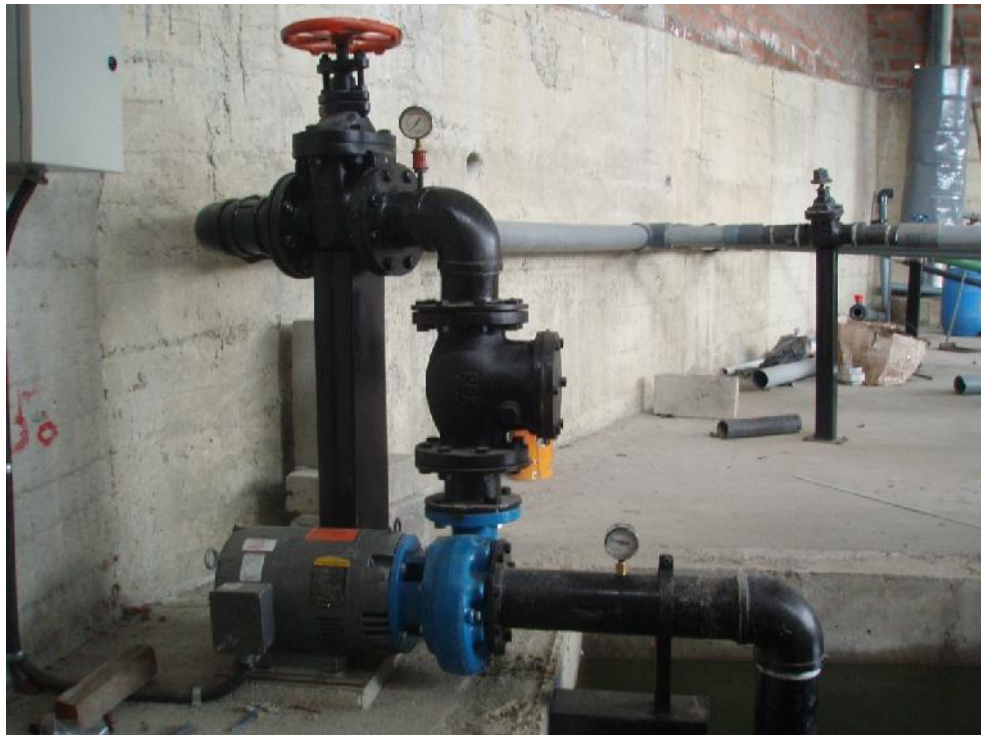
Figura 11: Bomba Hidráulica de 10 hp trifásica. Fuente: Autor
