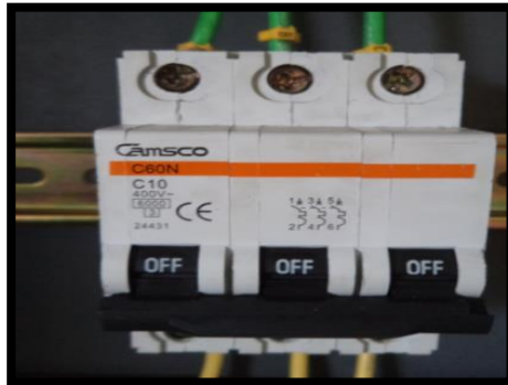
Figura 25. Breaker de 10 Amperios.
