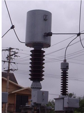
Figura 3.11 Transformador de corriente clase 0.5
