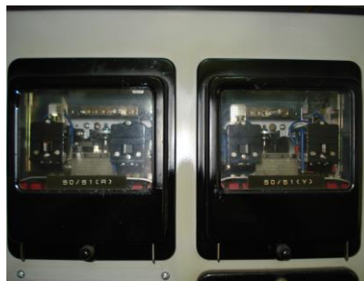
Figura 3.12 Relés electromecánicos de protección de sobrecorriente CO81D
