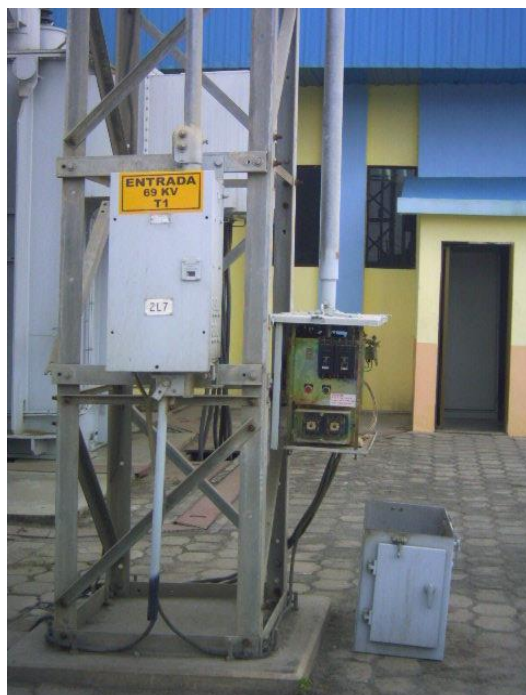
Panel de control de Cuchillas de Entrada y Salida de 69 kV
