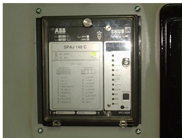
Figura 3.7 Relé de sobrecorriente SPAJ 140C
