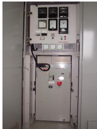
Figura 3.6 Interruptor de Vacío de 13.8 kV
