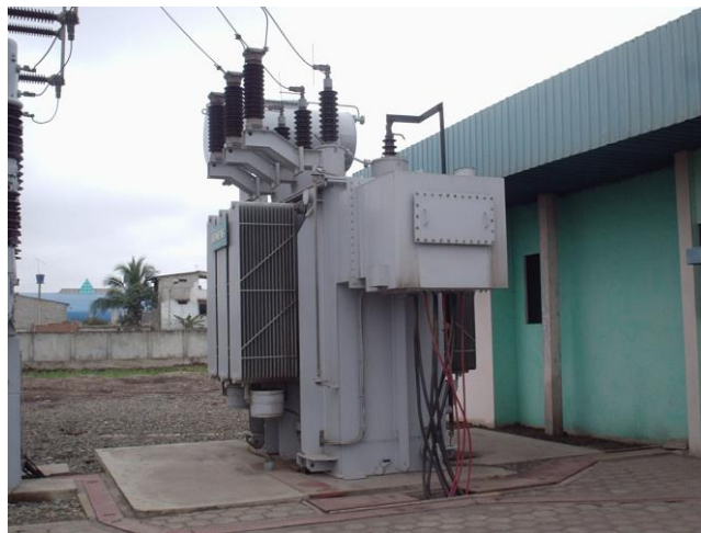
Figura 3.3 Transformador de potencia de 16/20 MVA
