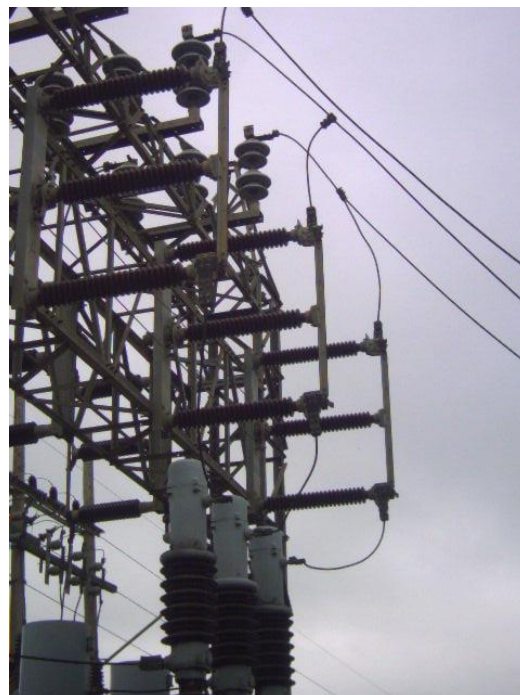
Cuchillas Motorizadas de 69 kV (Salida)
