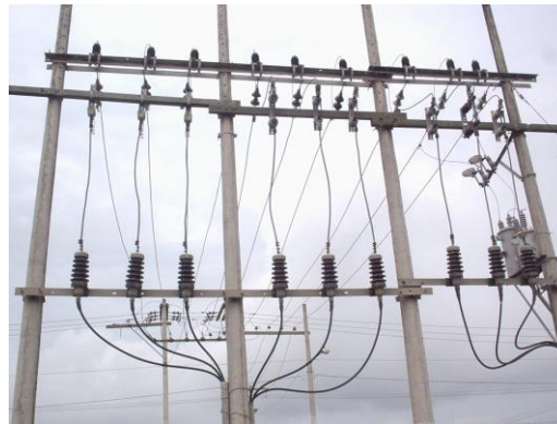
Figura 3.8 Salidas del circuito de 13.8 kV
