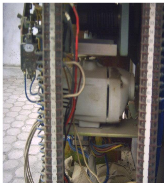
Motor de Cuchillas de Salida de 69 kV
