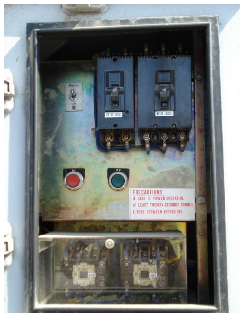
Mando de Cuchillas Motorizadas de 69 kV (Salida)
