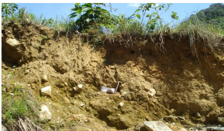
Fotografía Nº 8; Afloramiento de depósitos Coluviales a lo largo de la quebrada Barbascal.
