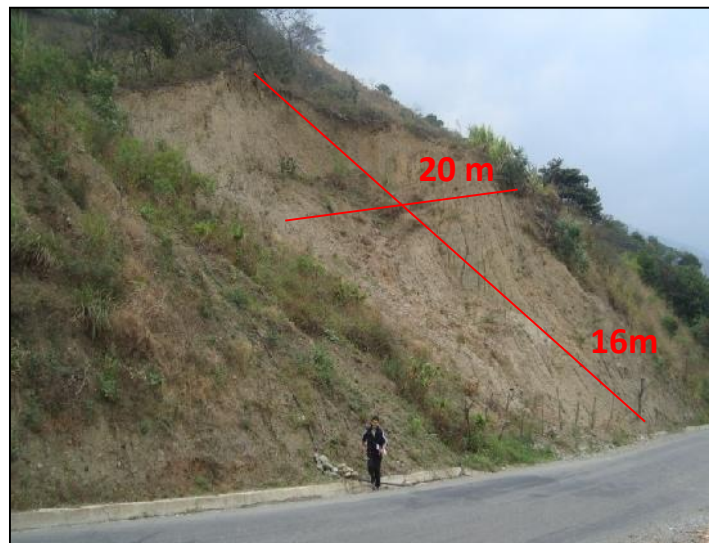
Fotografía 12. Deslizamiento Barrio Cararango.
