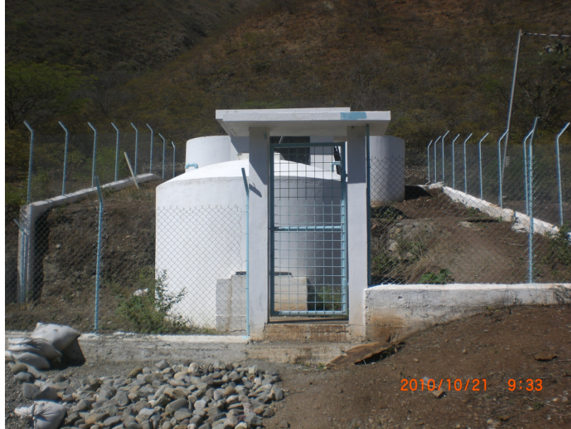
Anexo 02. Tanques de Distribución de Agua Para Consumo Humano
