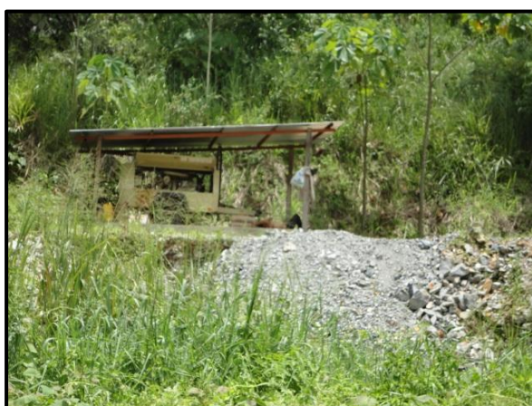
Foto N° 27: Zona de Compresores
