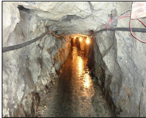
Foto N ° 12: Iluminación galería principal de la Labor Minera El Valle
