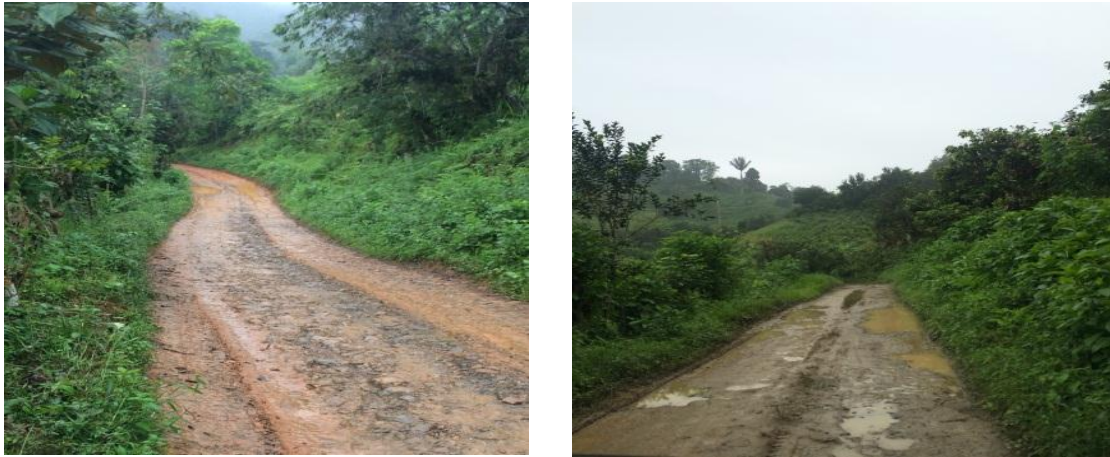
Figura 24. Vía de tercer orden desde el Sitio Birón hasta el Condominio los Ingleses. Fuente: El autor
