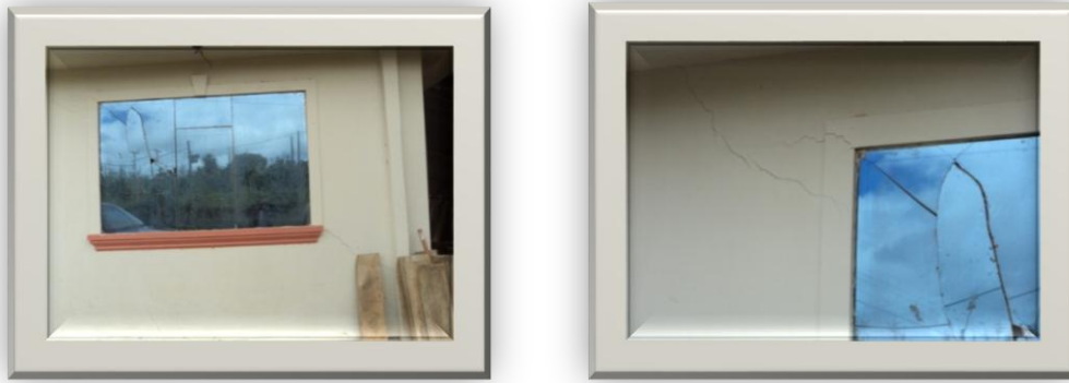
Foto Nro. 12.- Fisuras
