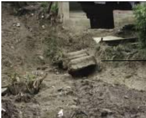
Foto Nro. 6.- Vivienda afectada por flujo de lodos o colada de barro.
