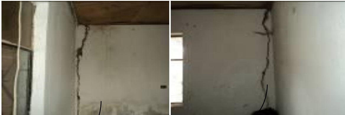
Foto Nro. 26.- Contracción térmica.
