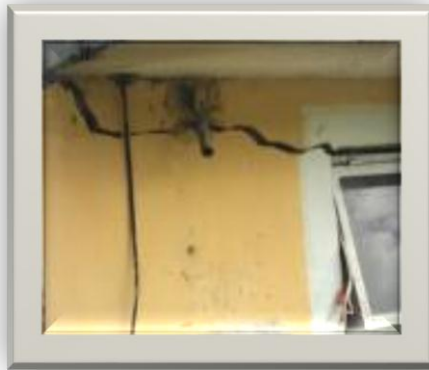
Foto Nro. 13.- Grietas en la mampostería originadas por asentamiento diferencial de cimentación en el sentido X – Y. abertura de la grieta de 2 cm y rotura perpendicular al plano del muro con movimiento horizontal y vertical.
