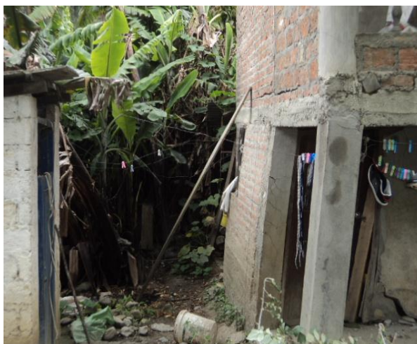
Foto Nro. 18.- Movimiento de la estructura soporte (Movimiento diferencial).
