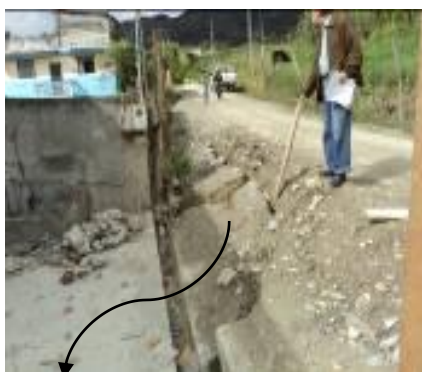
Grieta por donde ingresó el agua proveniente de lluvias y que afectó la cimentación de la vivienda de adobe colapsándola. Se visualiza una abertura del orden del 10 cm.
