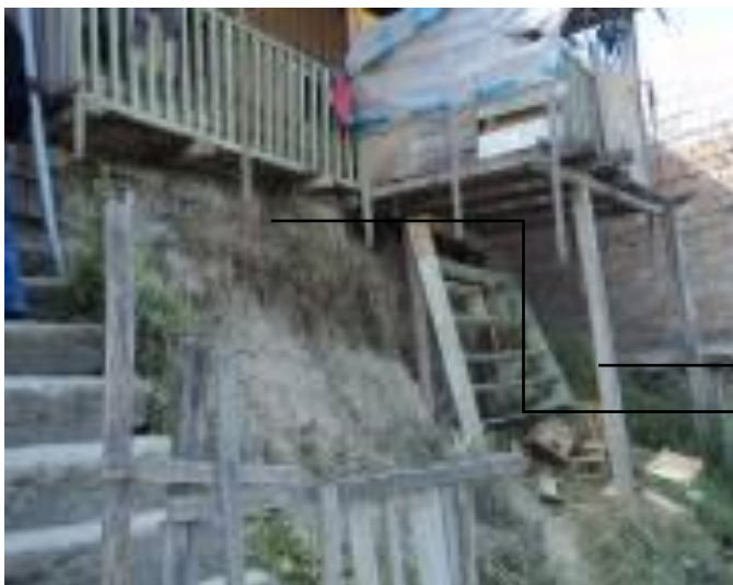
Foto Nro. 2. Construcción de una vivienda en forma deficiente, denominada obra artesanal.
