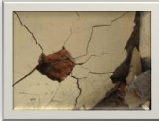
Foto Nro. 10.- Fisuras y grietas inclinadas del orden de los 6 mm presenta pérdida de mortero en zonas de alta compresión y grietas diagonales con rotura de las unidades de mampostería, deterioro avanzado del muro. Rotura en su plano.
