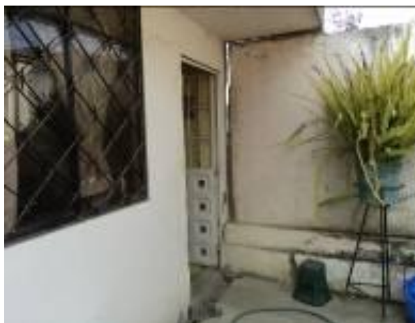
Foto Nro. 22.- Muros sometidos a estados de cargas diferentes.
