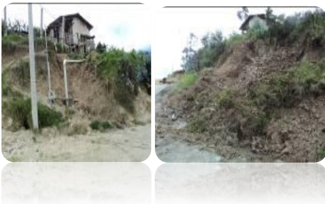
FOTO 40: VIVIENDA EMPLAZADA SIN CRITERIO TÉCNICO Y EN TALUD DESLIZABLE
