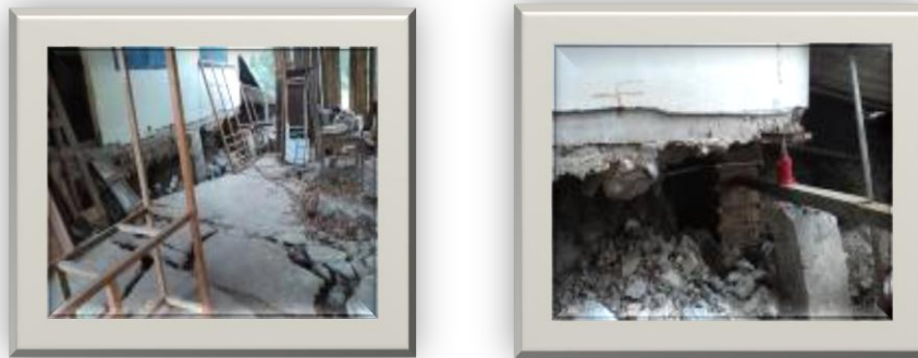
Foto Nro. 14.- Asentamiento diferencial
