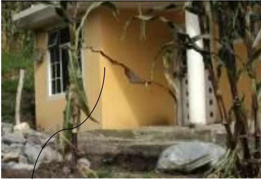
Foto Nro. 27.- Encuentro de dos paredes de distintas características que originan grietas.
