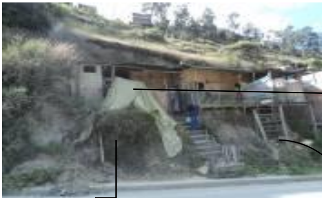
Foto Nro. 1. Construcción de una vivienda en forma deficiente, denominada obra artesanal.
