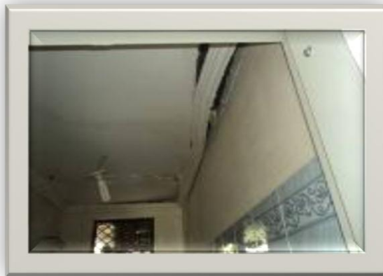
Foto: 32.5.- Despegue de la unión formada entre la mampostería de ladrillo y el cielo raso de Gypsum por efecto del asentamiento diferencial, Grieta de 6 cm entre el Gypsum y la mampostería.
