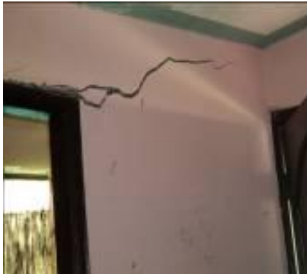
Foto Nro. 21.- Grieta a 45 grados generada por cargas concentradas.-
