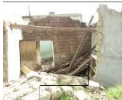
Colapso de la pared de adobe por tensión, generada por asentamiento diferencial de la cimentación
