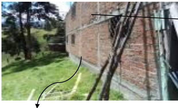
Foto Nro. 22.- Muro de mampostería pandeado por carga distribuida.
