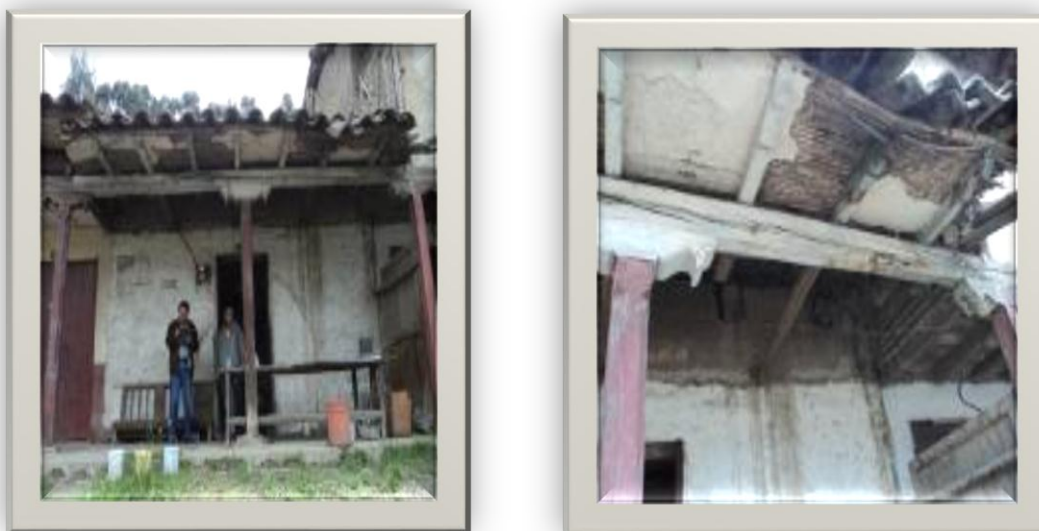
FOTO 39: FALTA DE CONSERVACIÓN DE LA VIVIENDA
