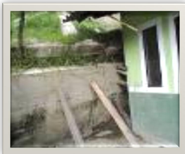
FOTO 38: FALLAS EN MUROS DE SOSTENIMIENTO QUE AFECTAN LAS VIVIENDAS
