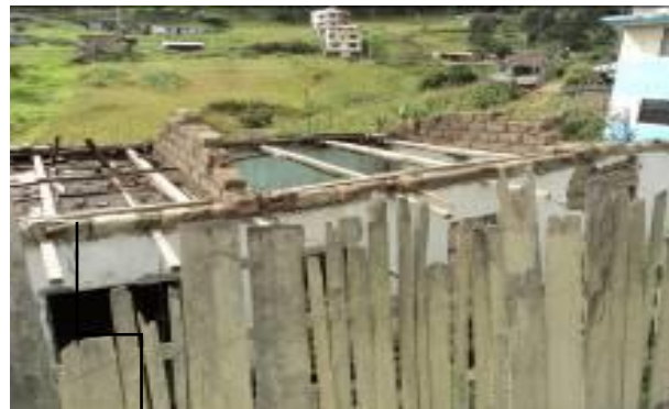
Elevado pesos que genera la madera de cubierta sobre los muros de adobe que generan fuerzas de tensión sobre los muros como efecto del asentamiento diferencial.
