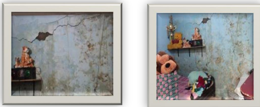
Foto 30.- Patología por humedad o eflorescencia.
