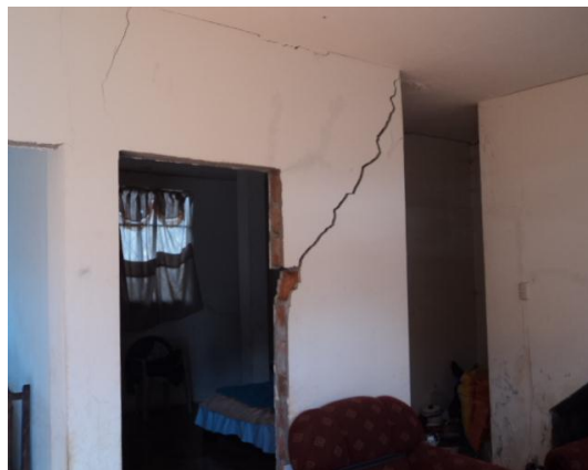
Foto Nro. 24.- Esfuerzos tangenciales generan grietas.
