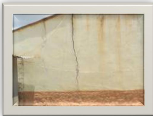
Foto Nro. 17.- Fisura originada por falta de adherencia entre el mortero y la mampostería de caña guadua
