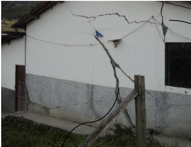
Foto Nro. 20.- Asentamientos diferenciales de los cimientos.
