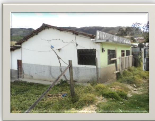
Foto 9.- Grietas y Fisuras
