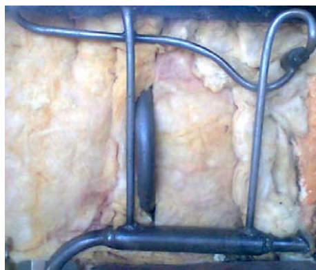
Fig. 53. Intercambiador de Calor.
