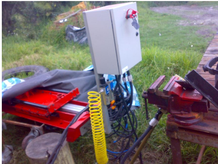
Fig. 5.26: Acoplamiento del sistema electro-neumático.
