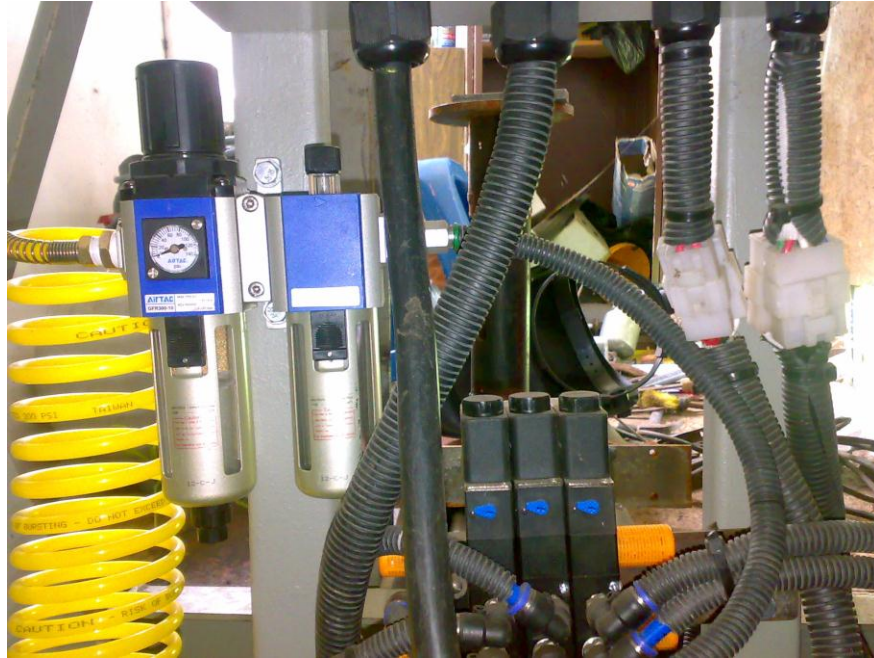
Fig. 5.5: Unidad de mantenimiento y conjunto de electroválvulas.
