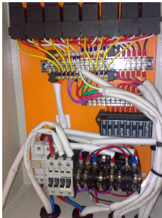
Fig. 5.4: Instalación eléctrica de comandos.
