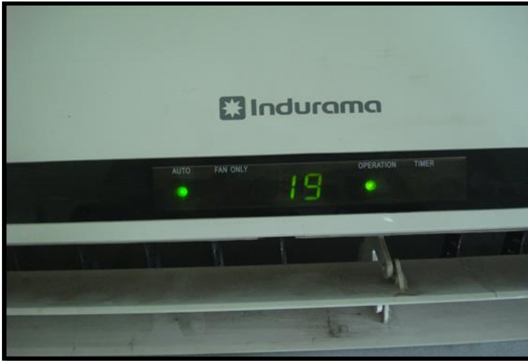
Figura 34: Temperatura fijada en el Aire Acondicionado
